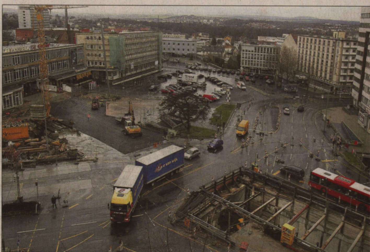
Großbaustelle: Sechs Monate vor Beginn der documenta wird vor und im Kulturbahnhof noch auf Hochtouren gebaut. Wenn die Weltkunstausstellung Mitte Juni ihre Tore öffnet, soll davon nichts mehr zu sehen sein.
